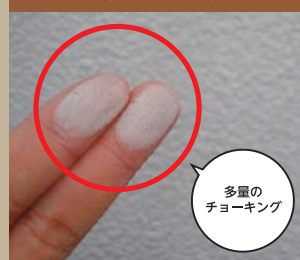
10年経過した外壁
